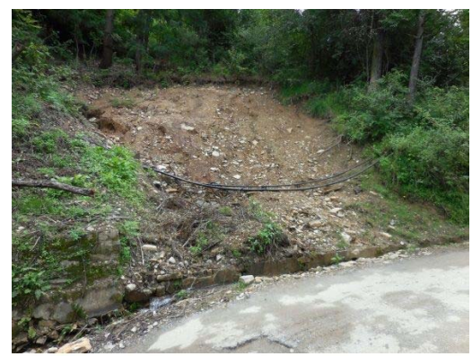
写真 6. 表層崩壊 (勾配緩い・降雨後)
