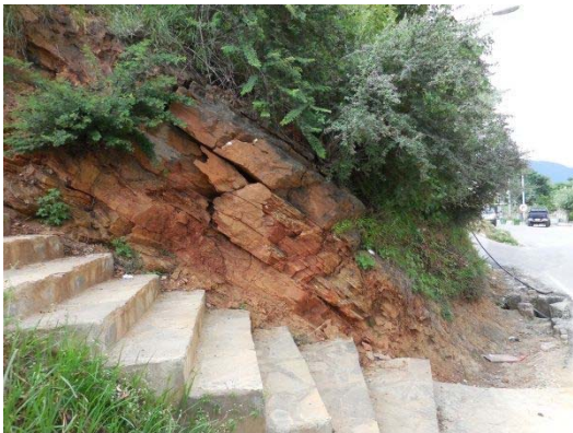
写真 3. 流れ盤斜面 (不連続面沿いに開口)
