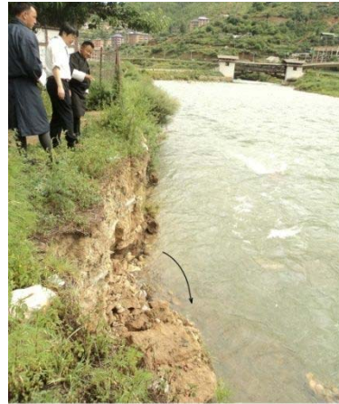
写真 7. 河岸の浸食状況 (比高 3m の河岸段丘)
