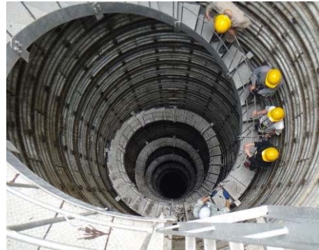
写真-2 深度 109m の集水井見学
