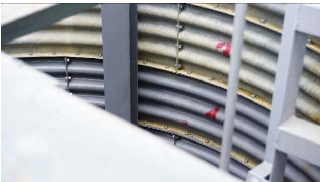
写真-5 写真下の濃いグレー部はポリエステル樹脂塗装
