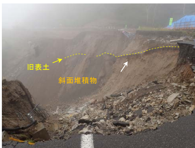
写真-3 Ta-d テフラに覆われる斜面堆積物の崩壊 白矢印:赤褐色火山灰(Ta-d: 9,000年前降灰)
