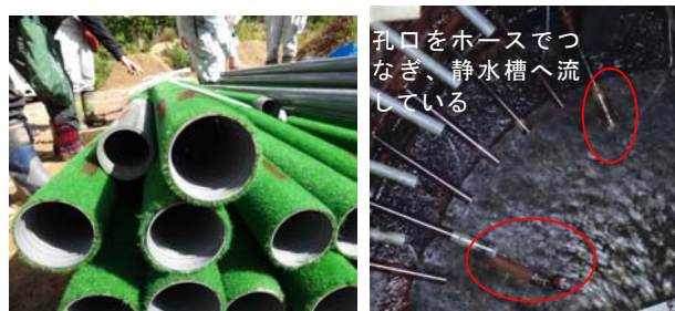
写真-2 目詰まり対策(左：植毛パイプ、右：酸素遮断策)
