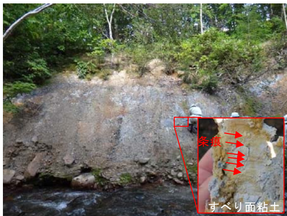
写真-1 地すべり末端部の状況
