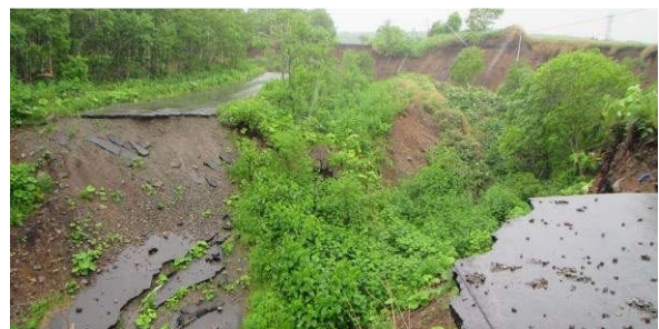
写真-3 幌萌地区地すべり 滑落崖の状況
