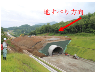
写真-1 忍路地区の地すべり
