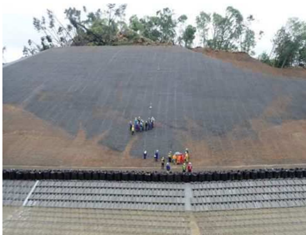
写真-1 水路開削工事ののり面で観察された岩盤すべり移動土塊先端部
