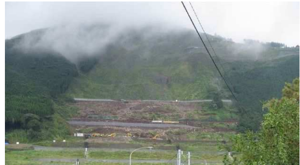
写真-3:大規模崩壊地 斜面上部は概ね復旧済み、最上部は霧の中。
