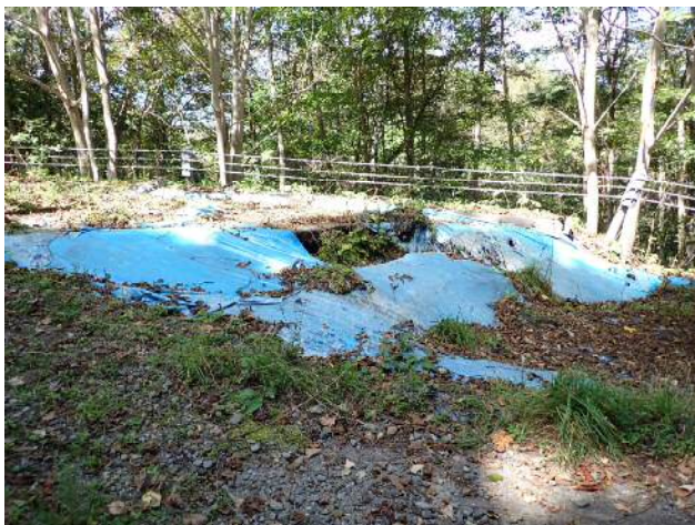
写真-1 大きな段差が生じた町道
